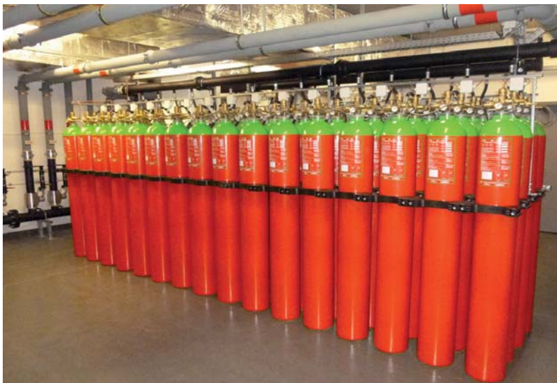
Obrázek č. 30 Umístění vysokotlakých lahví s dusíkem ve strojovně GHZ (archiv NK Praha-Hostivař)
