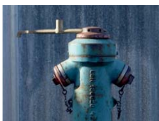
Obrázky č. 42, 43, 44 Ovládání nadzemních hydrantů klíčem
