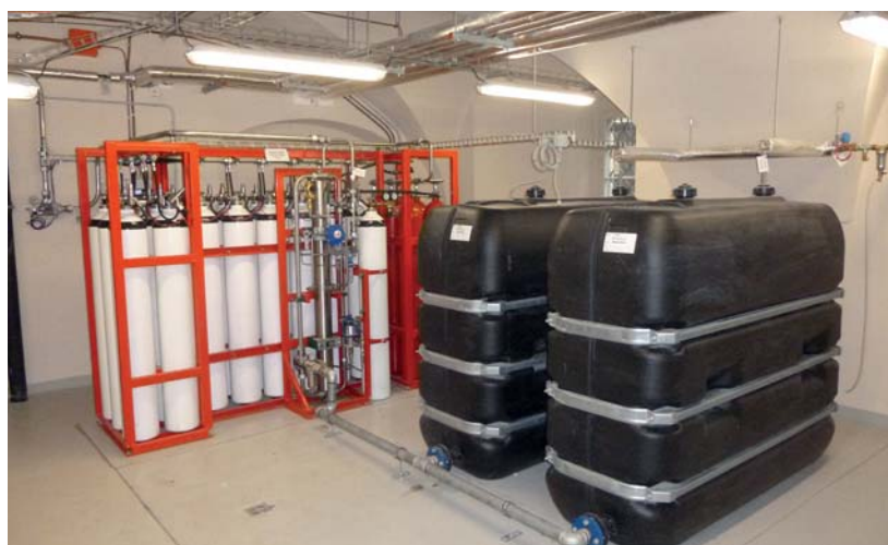
Obrázek č. 28 Strojovna MHZ (NK Klementinum, Praha)
