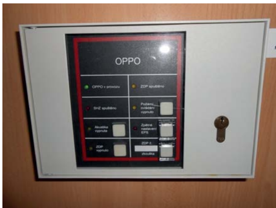
Obrázek č. 25 Obslužné pole požární ochrany
