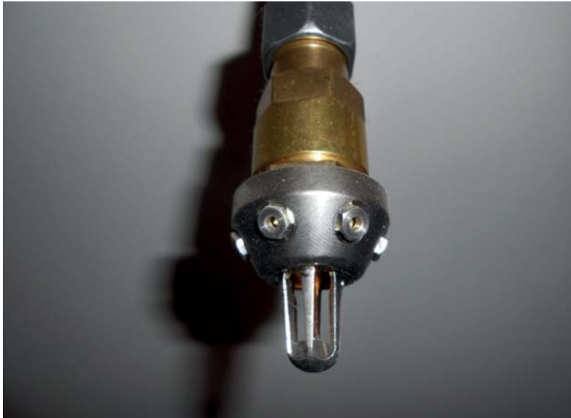
Obrázek č. 29 Mlhový sprinkler MHZ (NK Klementinum, Praha)
