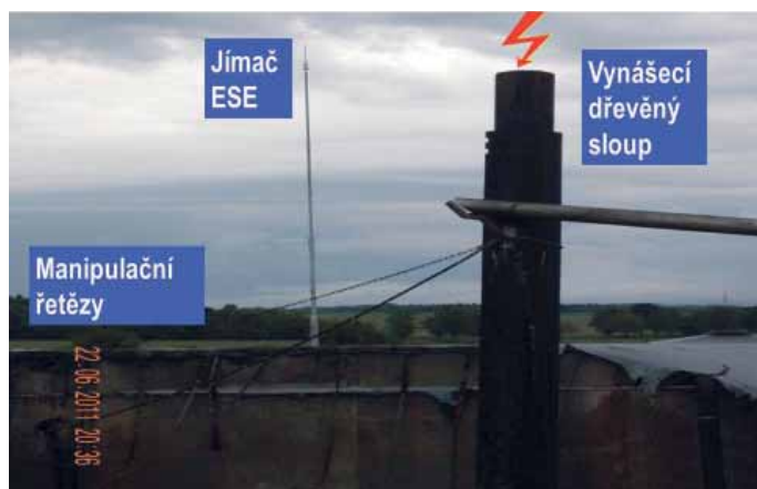
Obr. 3 Poškozená technologická část fermentor po úderu blesku do ochranného prostoru jímače ESE
