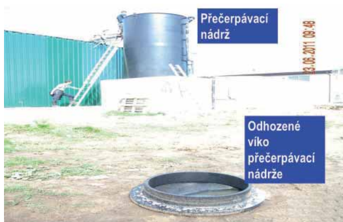
Obr. 5 Odhozené víko přečerpávací nádrže po výbuchu směsi
