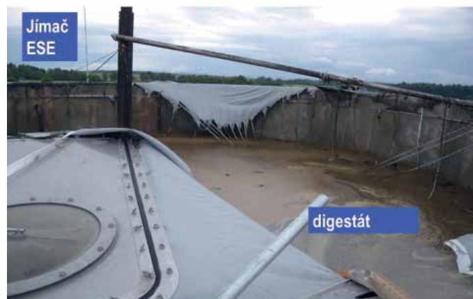
Obr. 6 Pohled do poškozené vnitřní jímky fermentoru, která se celá nachází v ochranném prostoru jímače ESE
