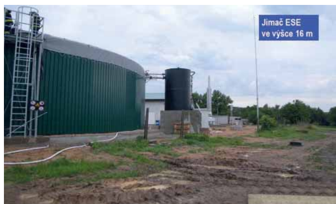
Obr. 7 Celkový pohled na umístění jímače ESE, který je vzdálen 13 m od okraje fermentoru
