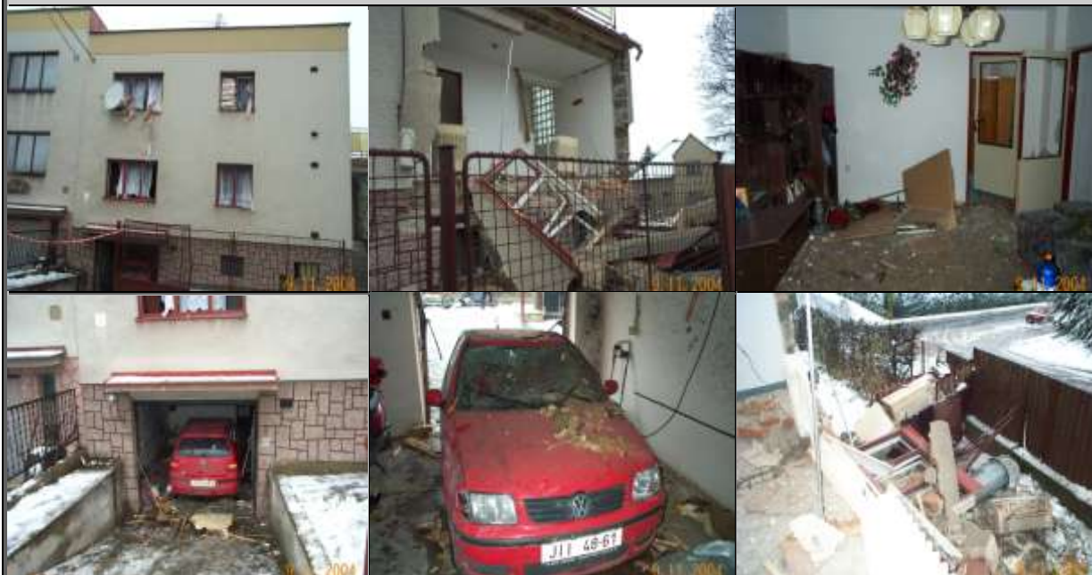
Požár rodinného domu Jamné
