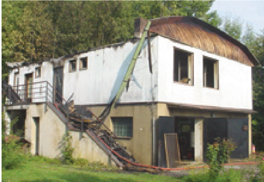
2003 – požár rodinného domu v Golčově Jeníkově
