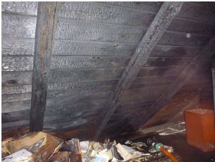
Ilustrativní obrázek HZS Olomouckého kraje z března 2016 – Požár rodinného domu kvůli jiskře z komína
