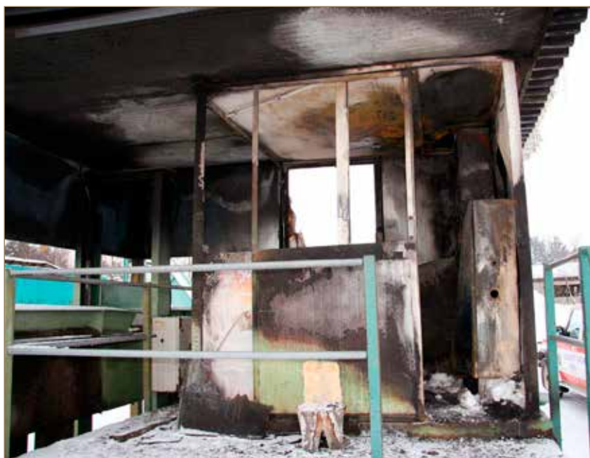
Obr. č. 1: Čelní pohled na velín se vstupními dveřmi a pravým bokem napájecího rozvaděče odkůrovací linky.
