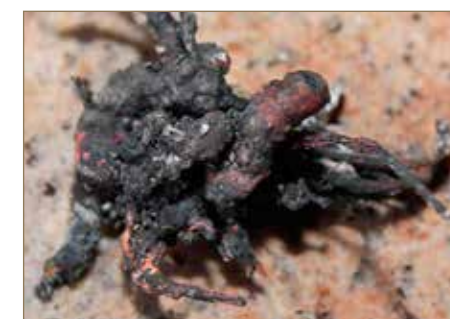
Obr. č. 5: Pohled na markanty zřetelné na elektroinstalaci napájecího modulu jisticích a spínacích prvků.
