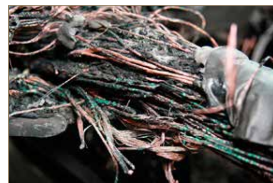
Obr. č. 7: Porušení vodičů vedených v kabelovém svazku místem kriminalistického ohniska.
