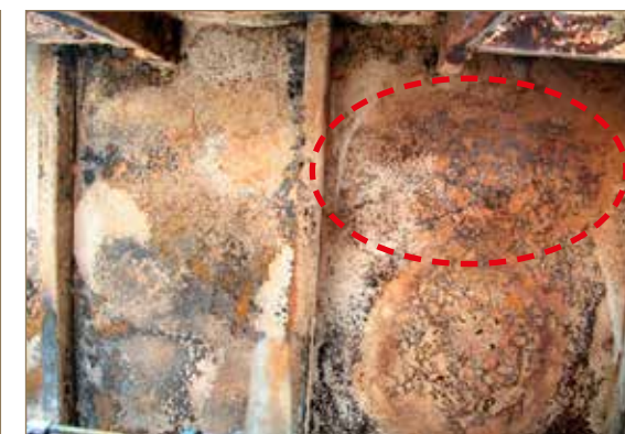
Obr. č. 4: Pohled na ohniskové příznaky vnitřního plechového pláště v místě nad uložením turbodmychadla elektroagregátu.
