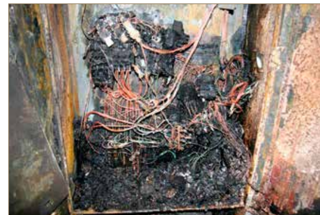
Obr. č. 2: Vnitřní prostor rozvaděče odkůrovací linky.
