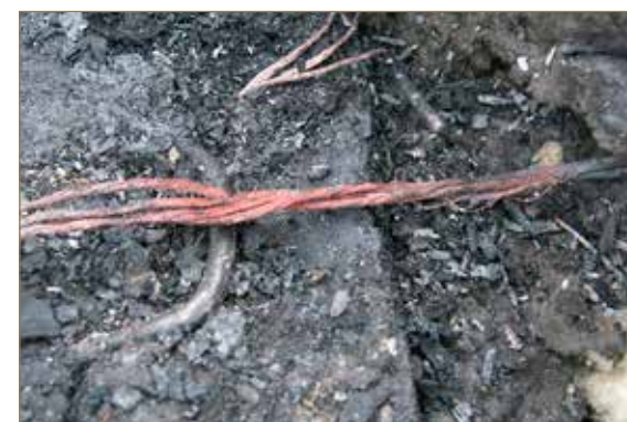
Obr. č. 4: Pohled na ohnisko vzniku požáru.
