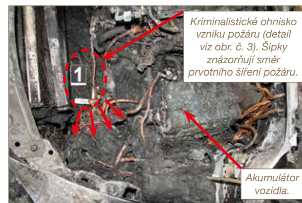
Obr. č. 2: Pohled na motorový prostor s vyznačením oblasti kriminalistického ohniska vzniku požáru a směru prvotního šíření požáru.
