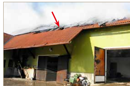
Obr. č. 1: Pozice instalovaného FV panelu, v jehož elektroinstalační rozvodnici „ZJHR box“ došlo ke vzniku požáru.
