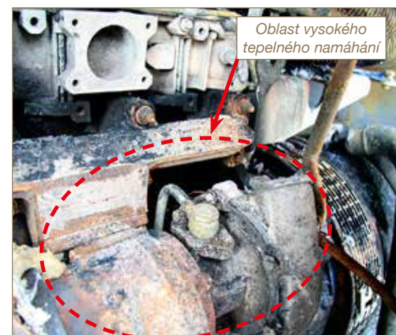
Obr. č. 5: Pohled na tepelné poškození primární a sekundární části turbodmychadla elektroagregátu.
