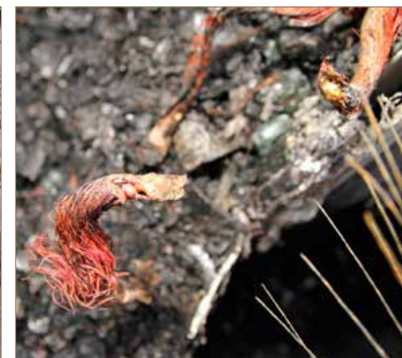
Obr. č. 4: Pohled na markanty v podobě Cu nátavů a tepelné přerušení jádra kabelu.
