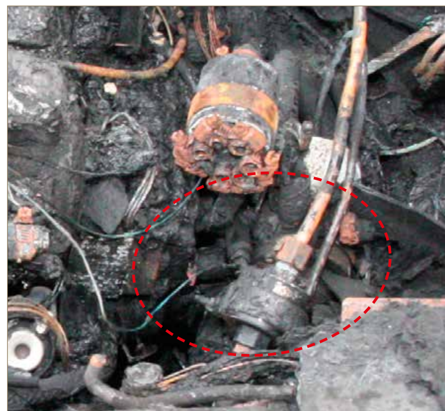
Obr. č. 3: Pohled na spoj, jehož netěsnost způsobil únik plynu LPG.
