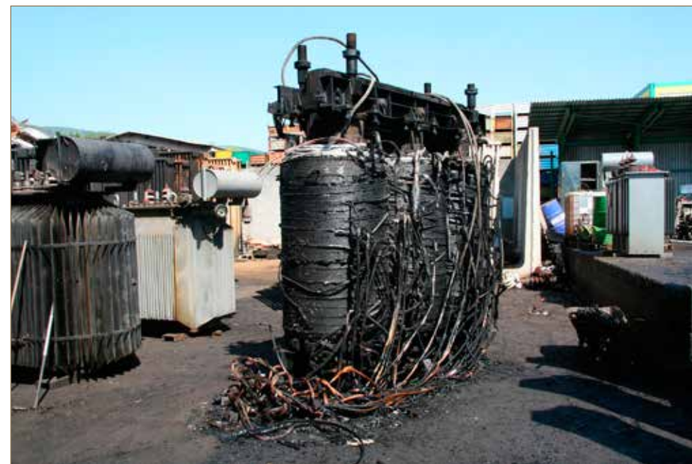
Obr. č. 2: Transformátor po vyjmutí z ocelového obalu.
