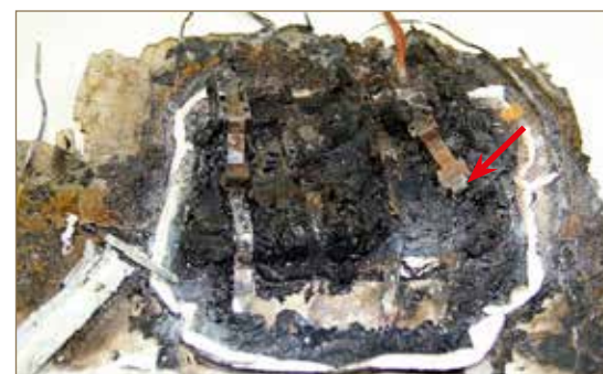
Obr. č. 3: ZJHR box, kde nekvalitní spojení bez zajišťovací pérové svorky mezi zápornou svorkou a propojkou sběrnice způsobilo vznik požáru.
