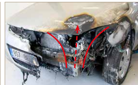
Obr. č. 3: Pohled na ohnisko vzniku požáru a tepelné působení na přední kapotě.
