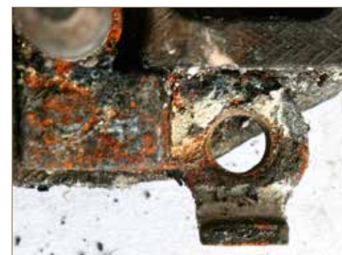
Obr. č. 4: Vyžhání vrchního šroubového kontaktu ochranného kolíku po odstranění mosazného šroubu.
