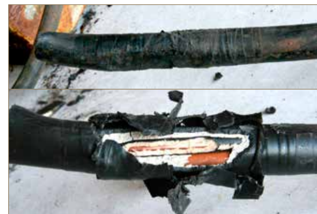
Obr. č. 4 a 5: Hlodavci poškozený silový kabel, který byl „opraven“ černou izolační páskou.
