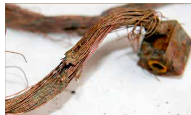
Obr. č. 3: Cu nátavy na fázových vodičích, které propojují hlavní napájecí přívod s vačkovým spínačem hlavního vypínače.
