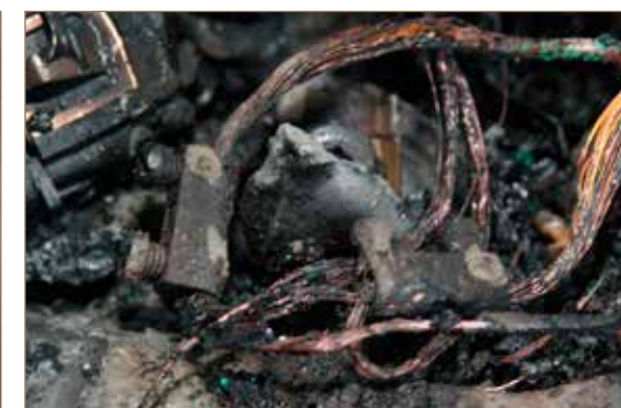
Obr. č. 6: Zbytky přístrojové svorkovnice.
