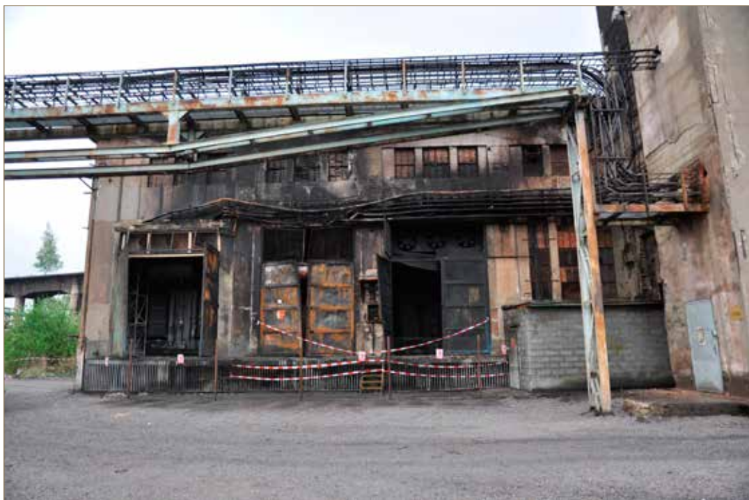
Obr. č.1: Transformátorové kobky.
