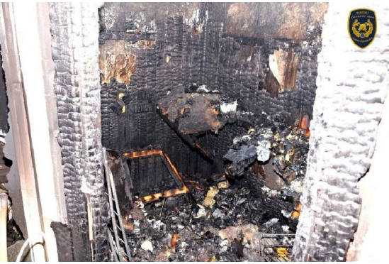
požár způsobený chybnou manipulací s vypínačem
