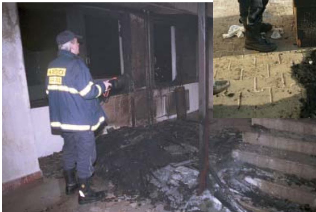
Zjišťování příčin vzniku požárů je součástí výkonu státního požárního dozoru.
