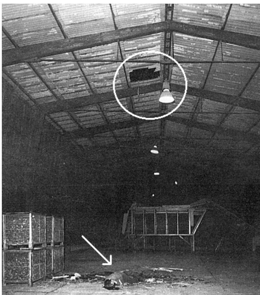
Obr. 4 (Smrtelný úraz hasiče při nezajištěném pohybu po střeše seníku)
