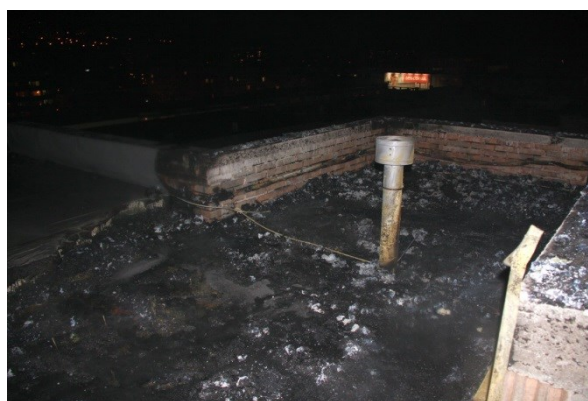
Obr. 5 Požářiště střechy administrativní budovy [34]
