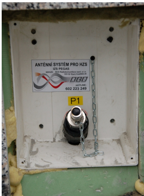
Obrázek 9 Připojovací bod P1 na Office b. c. Ostrava [14]
