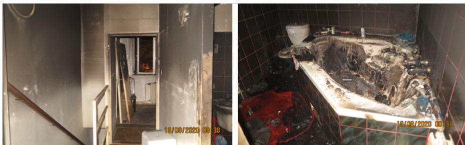
Požár v bytovém domě v Olomouci ze srpna 2020, kde zahořelo od svíčky vybavení koupelny.
