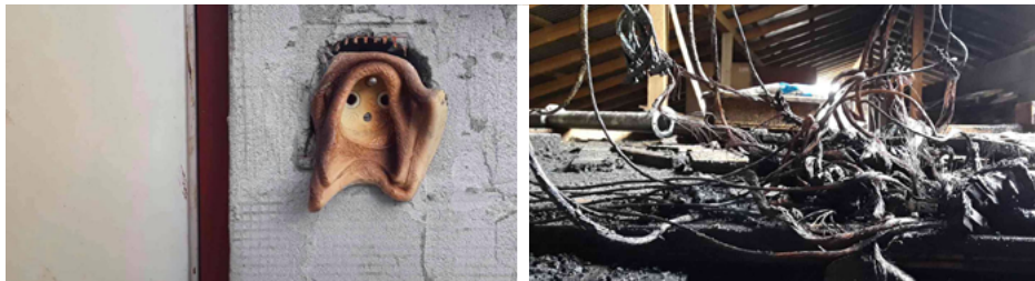
Nepřetěžujte jednotlivé elektrické zásuvky. Nepoužívejte poškozené kabely. Může hrozit zkrat a následně požár.
