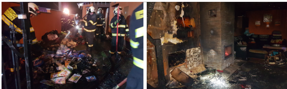
Požár v rodinném domě v Mostkovicích v prosinci 2019, kde se požár rozšířil ze střechy do celého domu.
