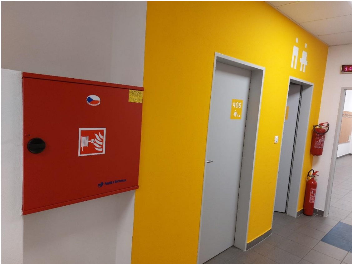
Foto 13 – Nástěnný hydrant a přenosné hasicí přístroje (v budově)
