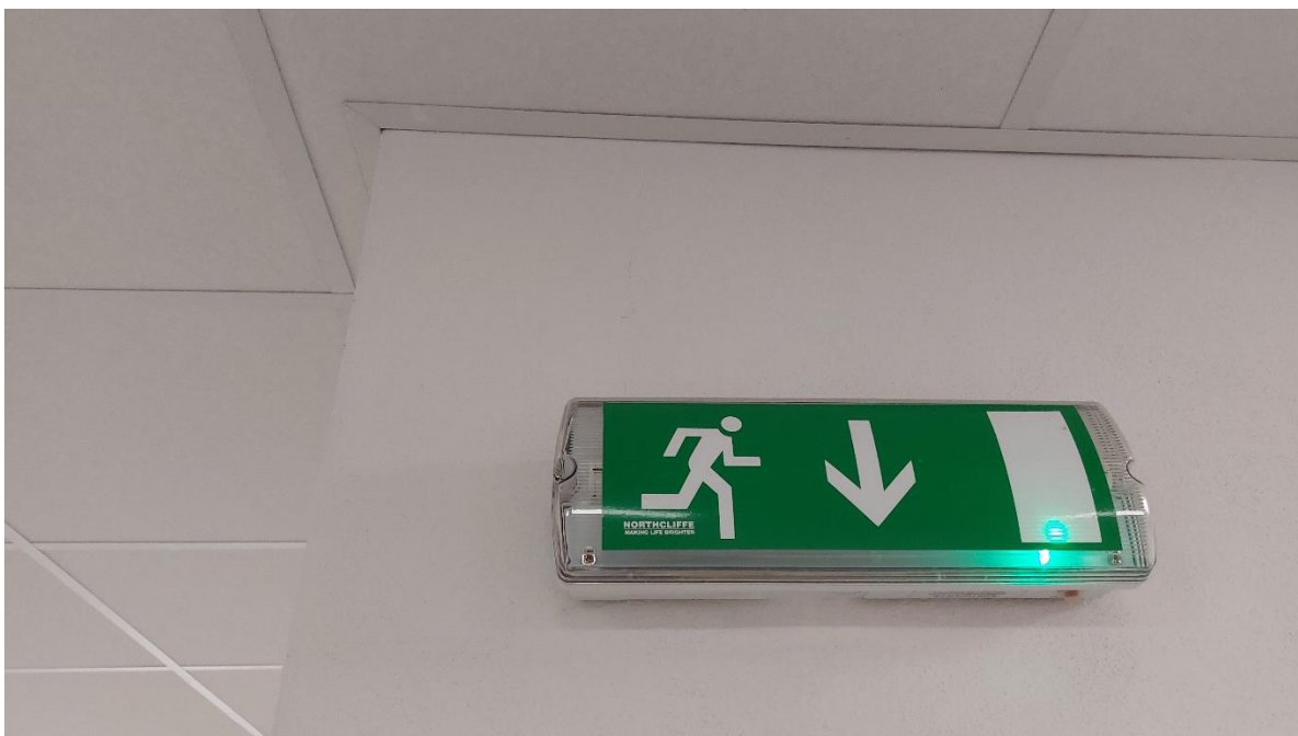
Foto 14 – Tabulka (osvětlená, na stěně pod stropem): Únikový východ – směr únikové cesty
