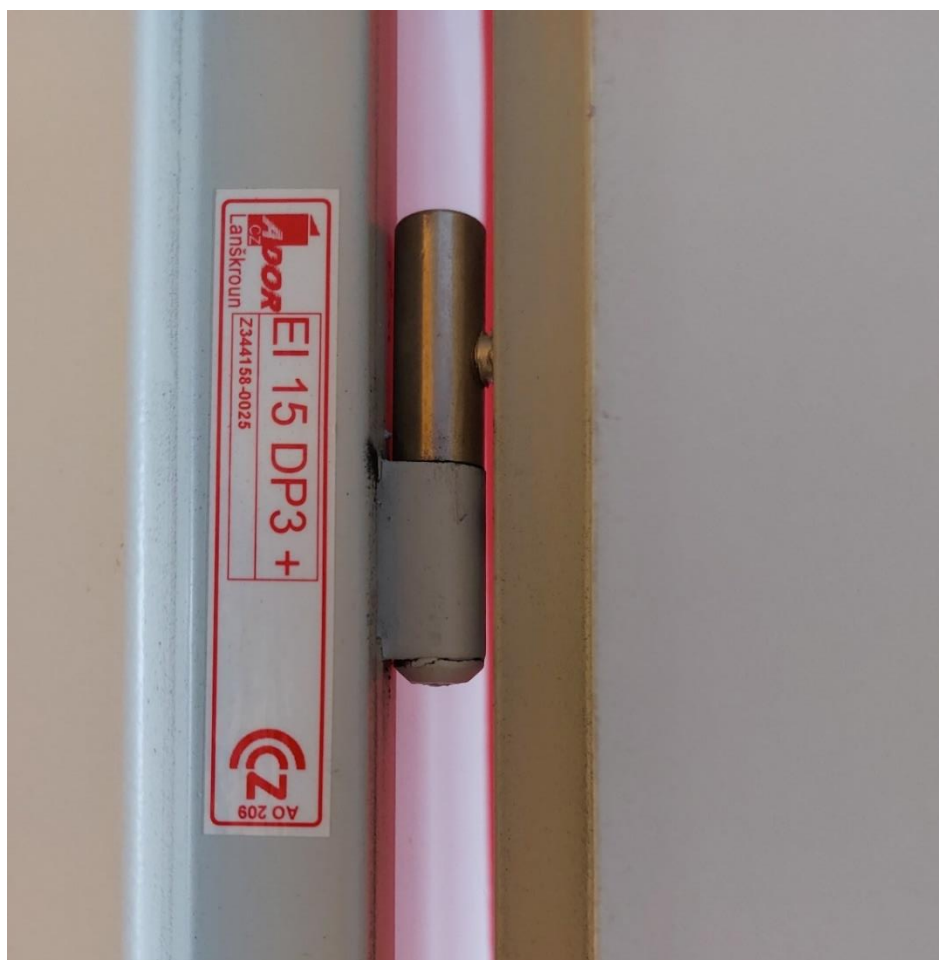
Foto 11 – Štítek na dveřích - požární odolnost dveří (15 minut)
