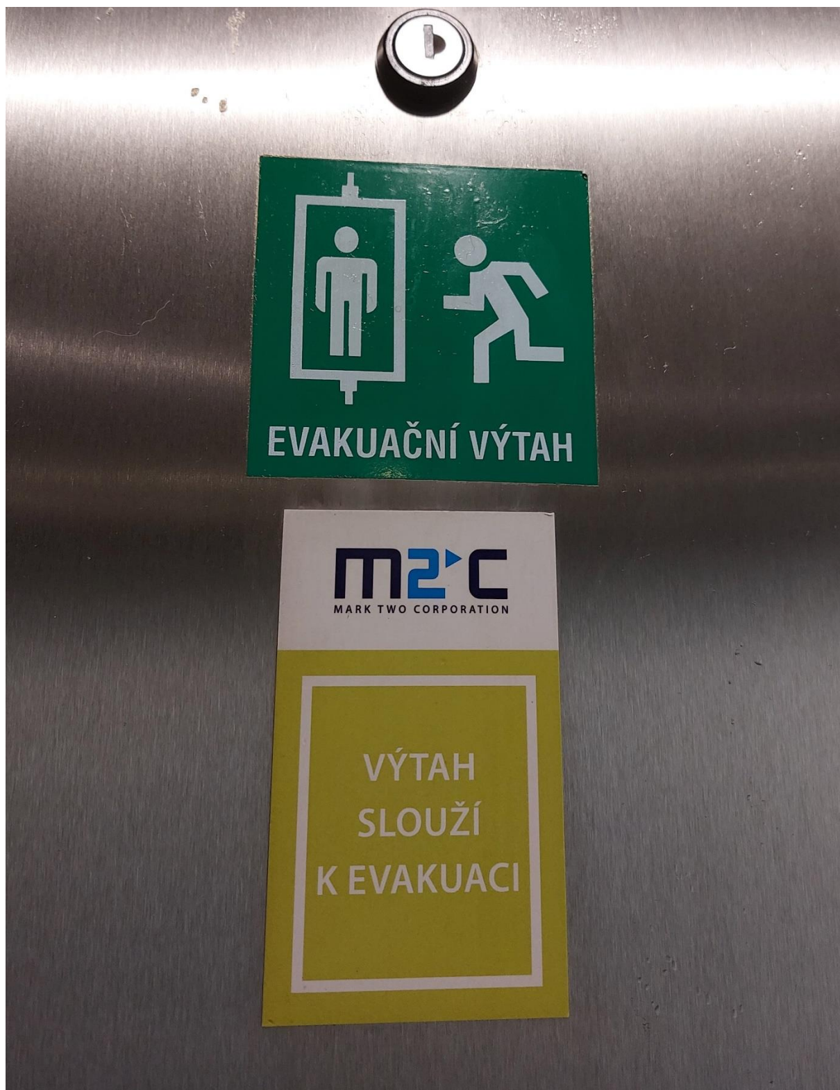
Foto 15 – Bezpečnostní značení na evakuačním výtahu
