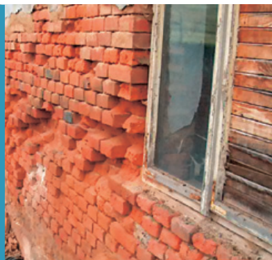
Staticky narušené konstrukce (vypadané, promáčené zdivo).
