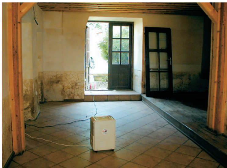
Příklad špatně instalovaného kondenzačního vysoušeče (nevyváženost výkonu přístroje, výšky promočení a objemu místnosti + otevřené dveře, kudy přichází nový, vlhký vzduch).
