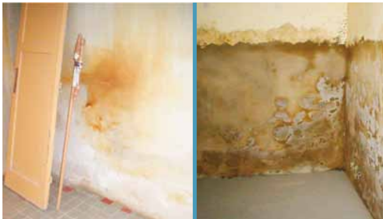
Špatně aplikovaná sanační omítky (plísně, solné výkvěty).
