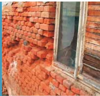
Staticky narušené konstrukce (vypadané, promáčené zdivo).
