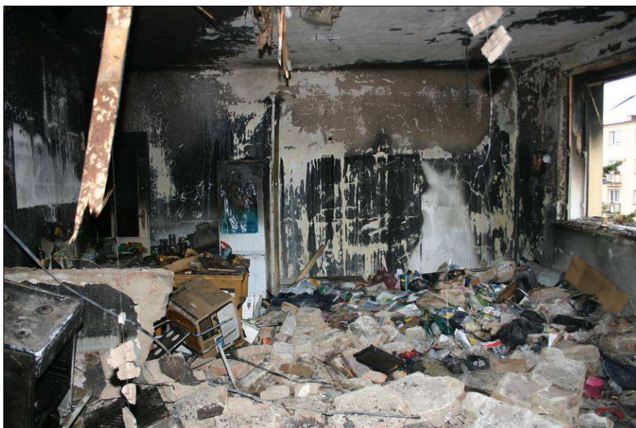
Fotografie č. 15 Následky účinků výbuchového děje pohled do susedního bytu B
