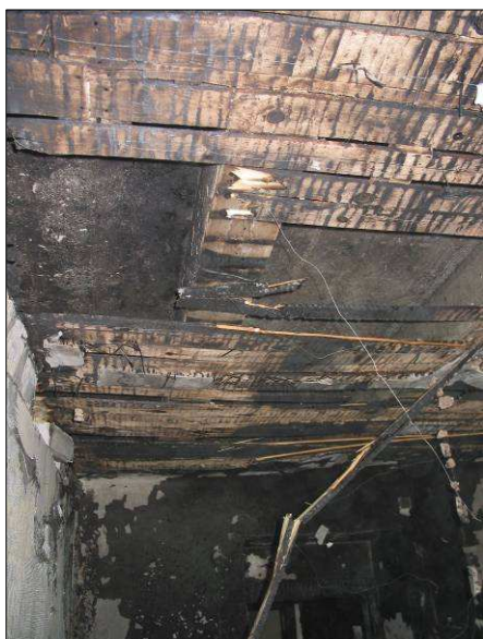
Fotografie č. 3 Ukázka poškozeného stropu účinky výbuchového děje
