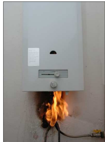
Fotografie č. 4 Požár unikajícího zemního plynu z karmy
