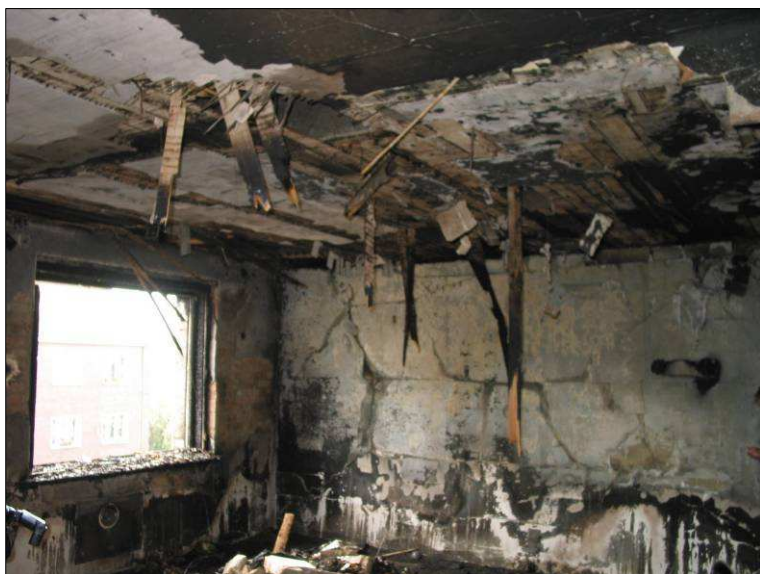
Fotografie č. 16 Pohled na poškozený strop a poškozenou stěnu se sousedním bytem A
