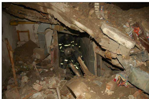
Fotografie č. 6 Ukázka destrukce stropu
