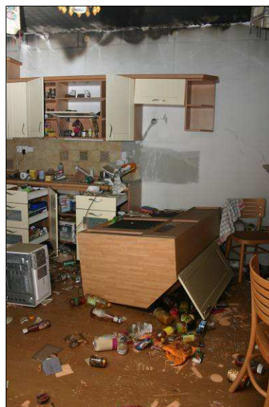
Fotografie č. 17 Pohled v sousedním bytě A na částečně poškozenou stěnu
