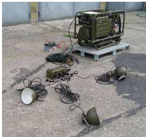
Obr. 54 Elektrocentrála ČSAB s osvětlovací soupravou
