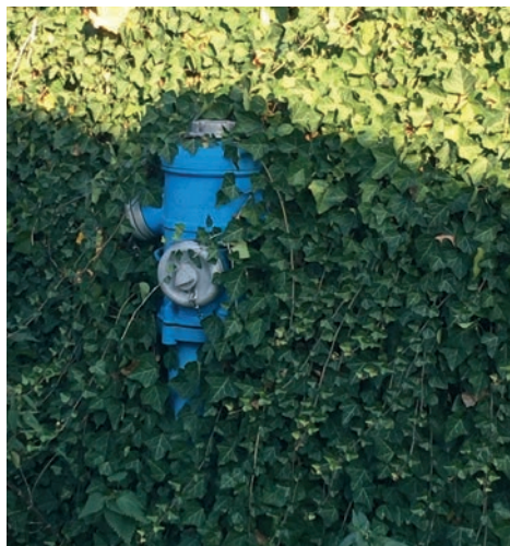
Nepřístupný nadzemní hydrant
