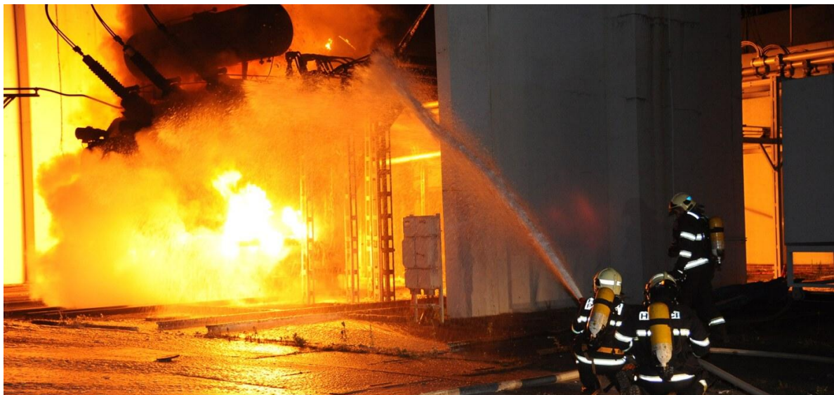
18.6.2013 POŽÁR VELKOKAPACITNÍHO TRANSFORMÁTORU Praha 11, Kunratická spojka 250
