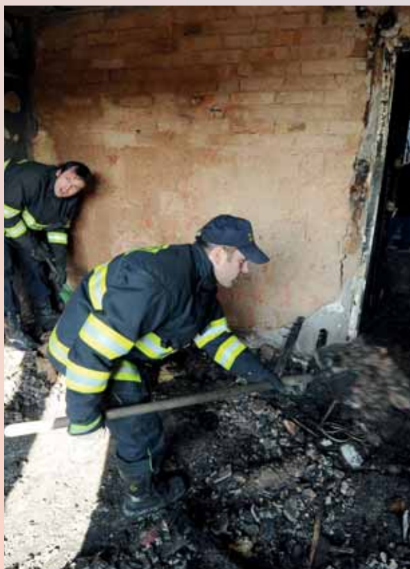
Těžká práce na místě požáru
