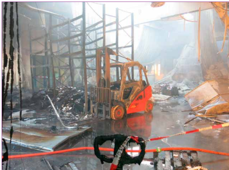
Obr. č. 3 – Expediční hala po požáru.
