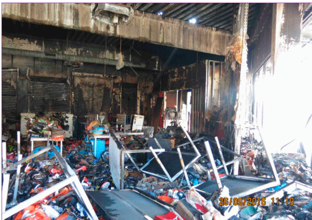
Obr. č. 3 – Vnitřní prostory prodejny – následky požáru.
