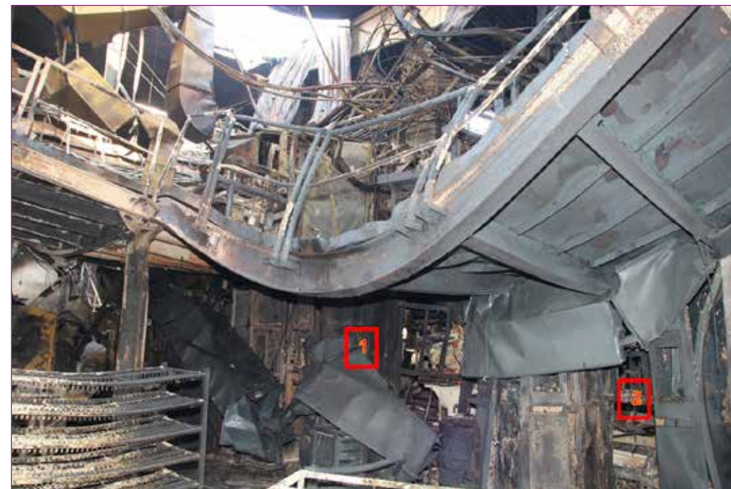
Obr. č. 3 – Pohled na požární a kriminalistické ohnisko – stříkácké kabiny PU1 a PU2.
