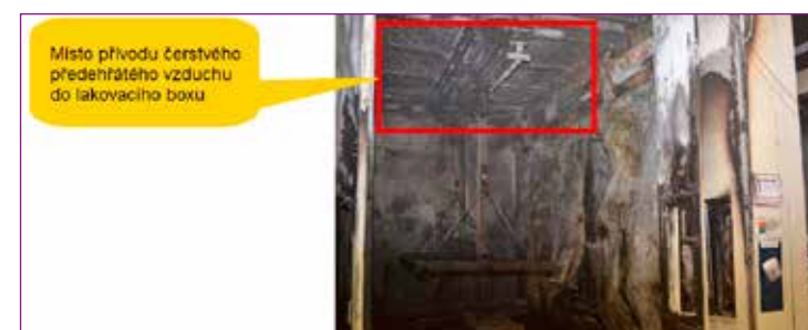
Obr. č. 2 – Vnitřní prostor lakovací kabiny po požáru.
