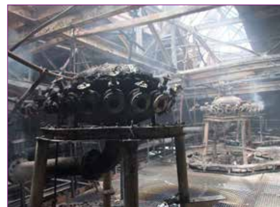
Obr. č. 2 – Hydro-cyklony – následky požáru.
