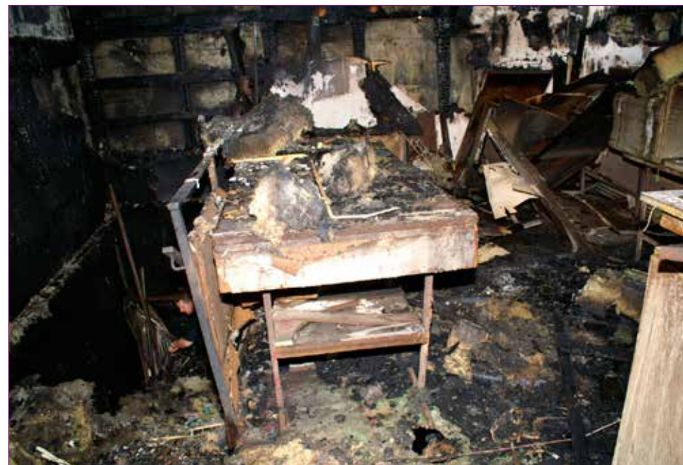
Obr. č. 4 – Výrobní část objektu – následky požáru.
