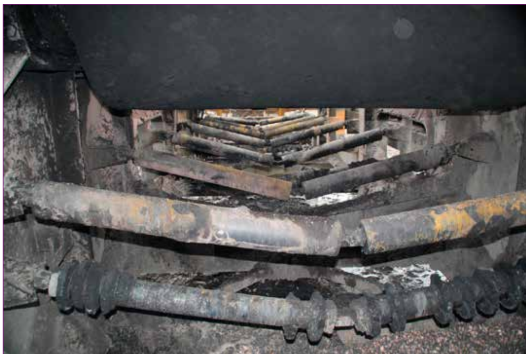
Obr. č. 3 – Válečky pásového dopravníku – následky požáru.
