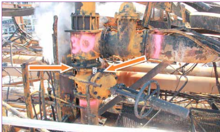
Obr. č. 2 – Detailní pohled na pojistný ventil – vyznačení míst porušeného těsnění přírubového spoje a následného úniku propylenu.
