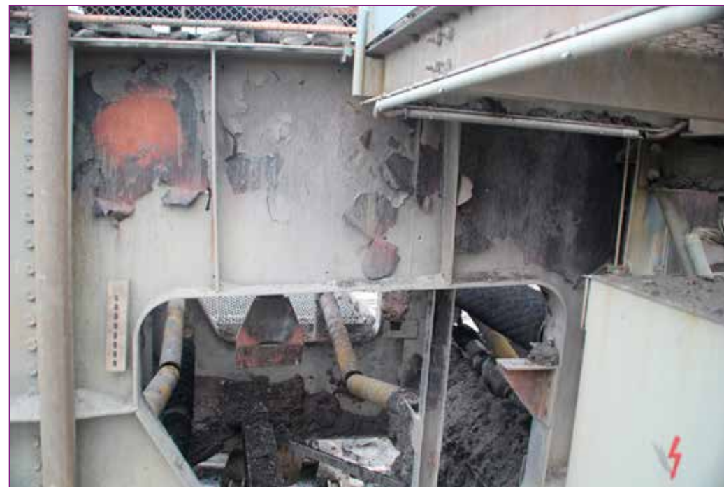
Obr. č. 4 – Vyžíhané skvrny v nátěru ocelové konstrukce.
