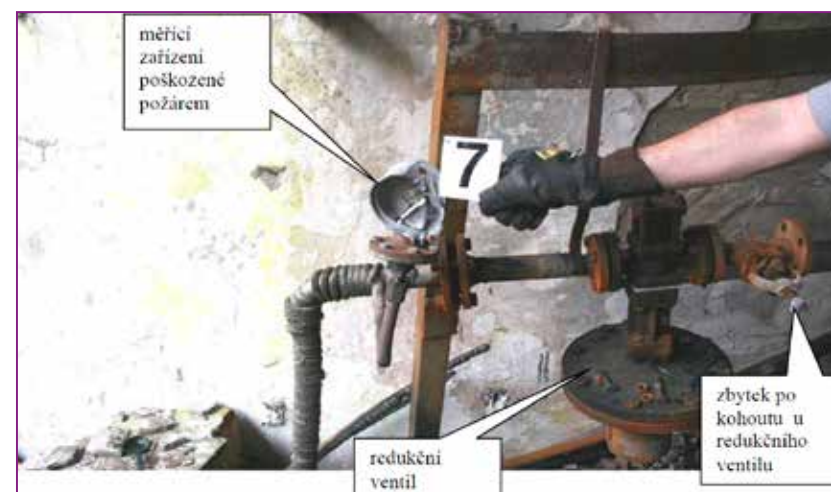
Obr. č. 6 – Odtavená část kovového manometru parovodu.
