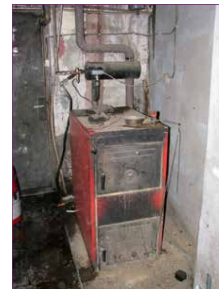
Obr. č. 2 – Kotel na tuhá paliva napojený na inkriminované komínové těleso.
