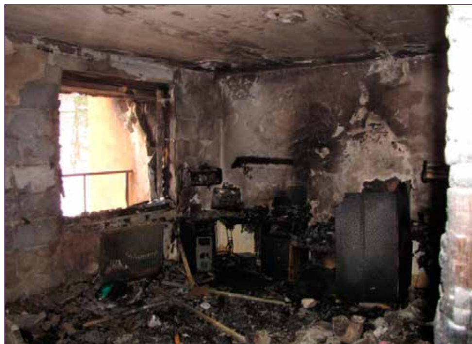
Obr. č. 3 – Jedna z bytových jednotek – následky požáru.
