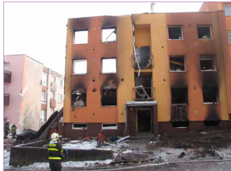
Obr. č. 1 – Následky výbuchu a požáru.
