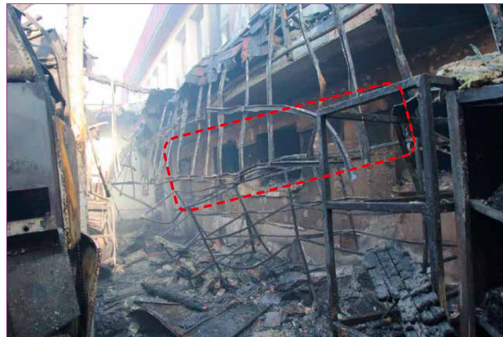
Obr. č. 6 – Vnitřní prostor skladu – zvýraznění oken bez požární odolnosti v nosné požárně dělící konstrukci.
