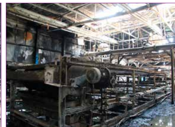
Obr. č. 3 – Pásové dopravníky – následky požáru.
