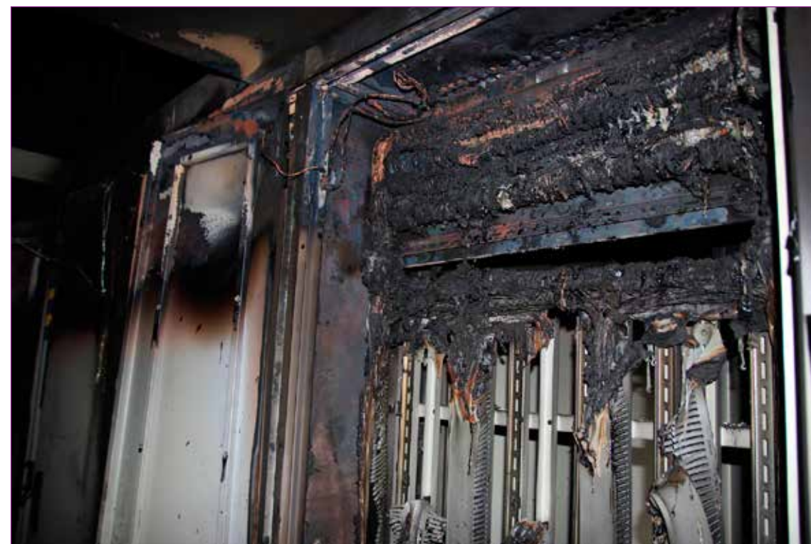
Obr. č. 1 – Rozvodná skříň v budově reléovny – poškození požárem.
