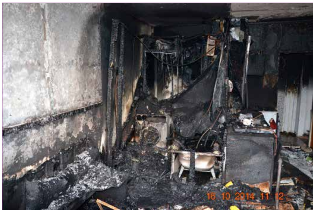
Obr. č. 4 – Místnost koupelny – místo vzniku požáru.
