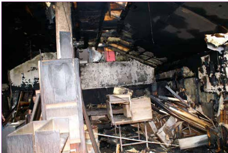
Obr. č. 3 – Výrobní část objektu – následky požáru.
