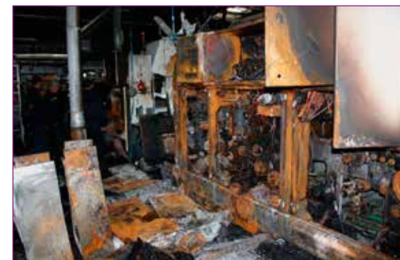
Obr. č. 3 – Následky požáru – zadní strana obálkovacího automatu.
