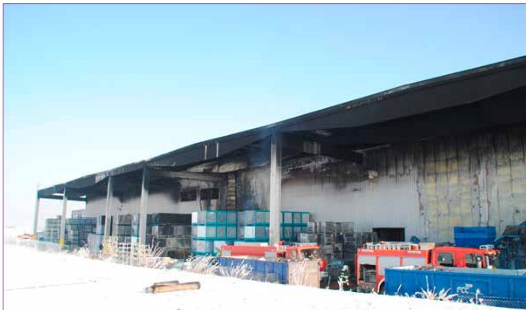
Obr. č. 1 – Celkový pohled na poškozený vnější plášť objektu.
