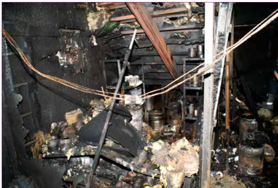
Obr. č. 2 – Prostor skladu chemických látek – následky požáru.
