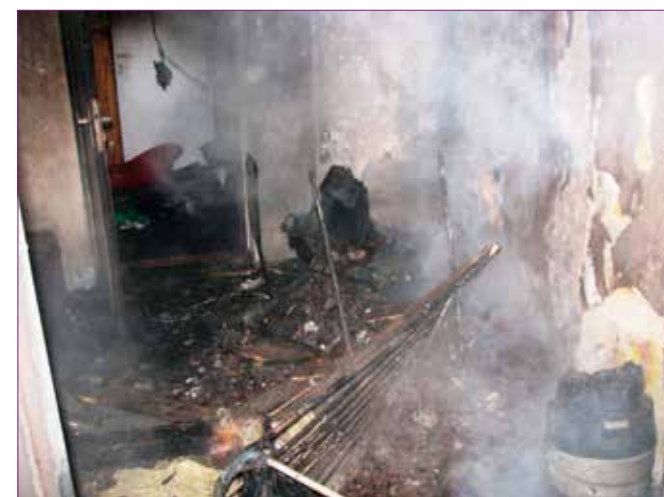
Obr. č. 3 – Ubytovací prostory zasažené požárem.
