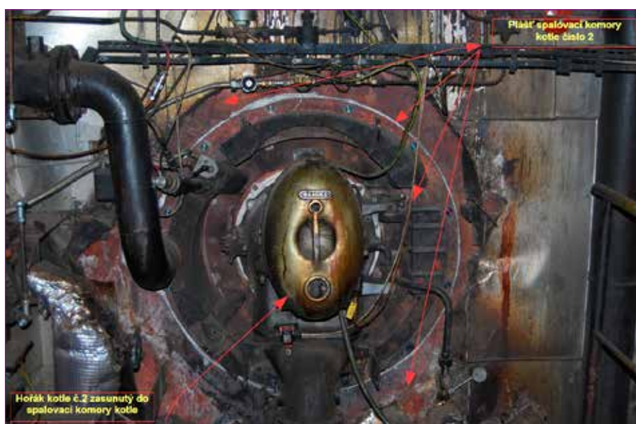
Obr. č. 3 – Prostor iniciace požáru č. 1 – hořák kotle č. 2.
