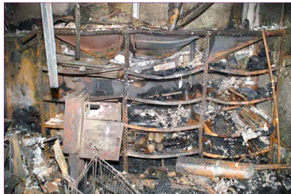
Obr. č. 4 – Vnitřní prostory – následky požáru.
