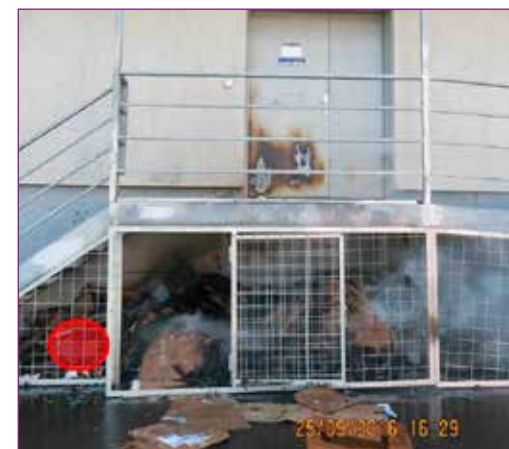
Obr. č. 2 – Rampa u kovového schodiště – vyznačení kriminalistického ohniska.
