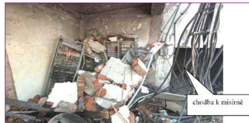
Obr. č. 5 – Pohled na elektrorozvodnu v A55/2.
