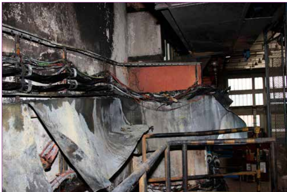
Obr. č. 2 – Kabelová lávka v depu kolejových vozidel – poškození požárem.
