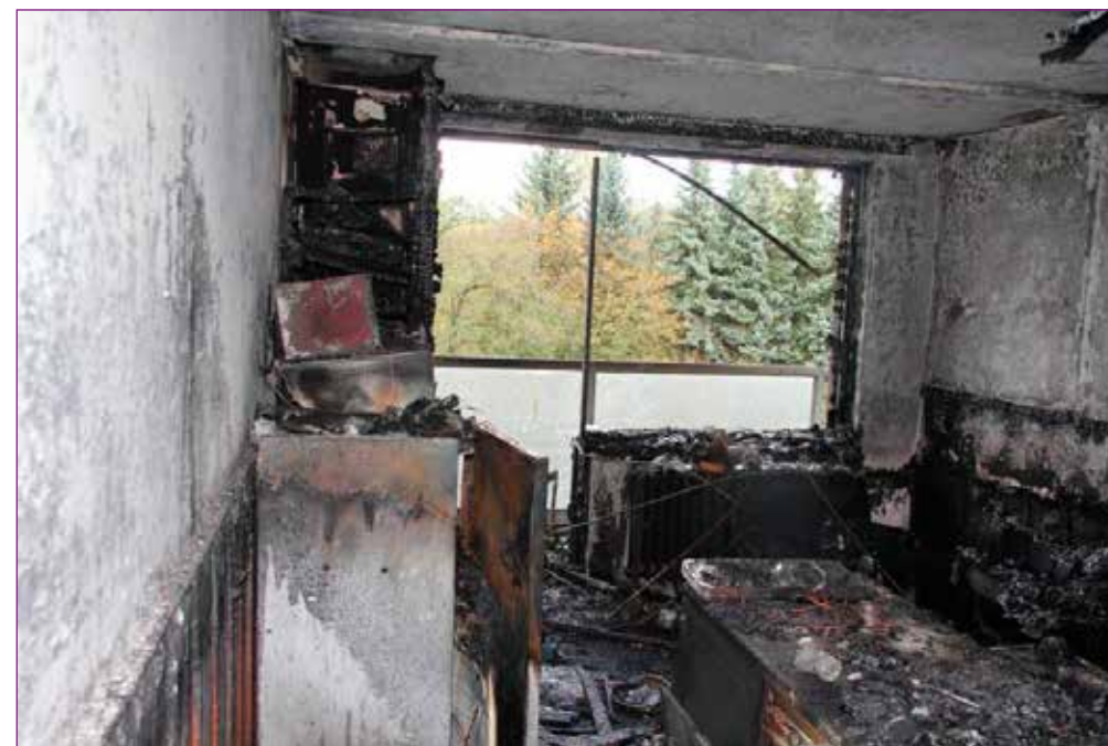
Obr. č. 6 – Prostory kuchyně – následky požáru.
