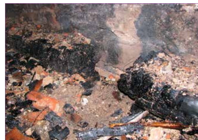
Obr. č. 4 – Kriminalistické ohnisko – prohořelý trám.
