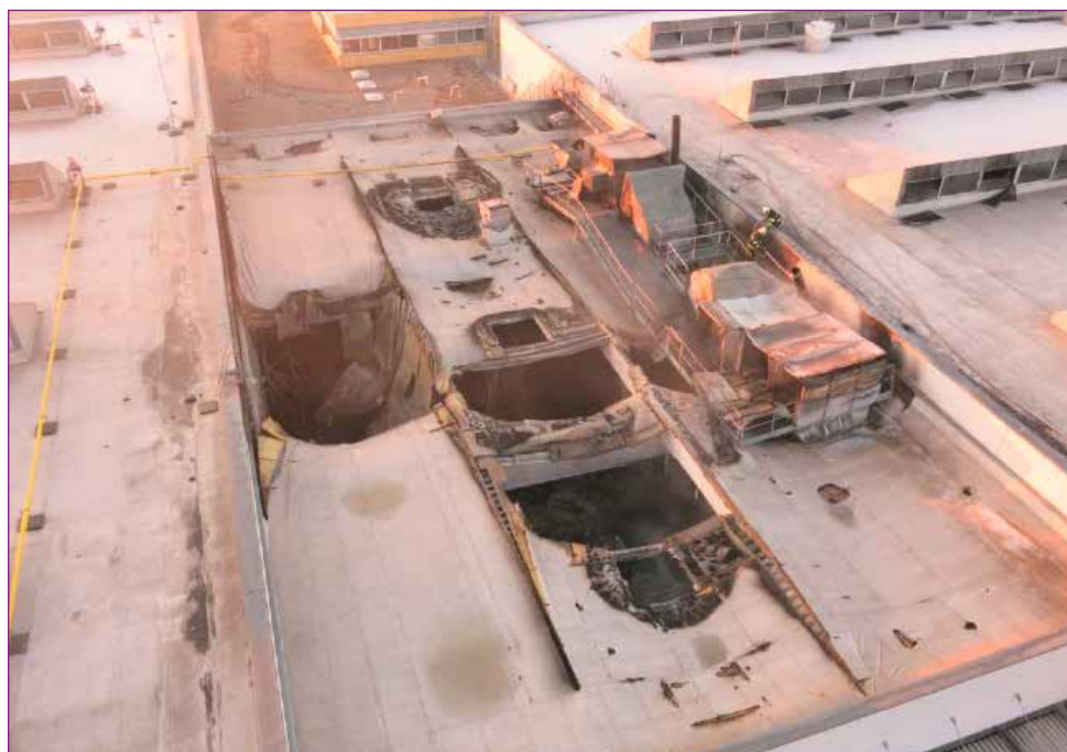
Obr. č. 4 – Střecha objektu po požáru.
