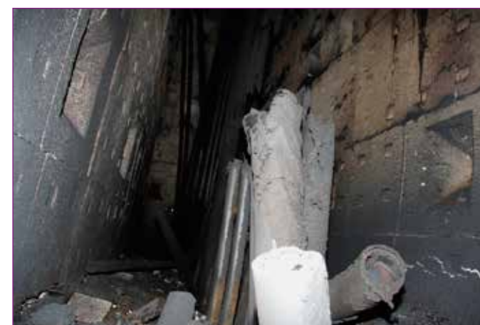
Obr. č. 5 – Požár č. 2 – nahlížecí okénko, kde byl požár zpozorován.
