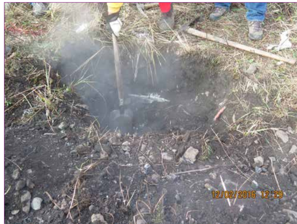
Obr. č. 4 – Výkopové práce – pára vycházející ze zeminy přibližně 2 dny po vzniku požáru.
