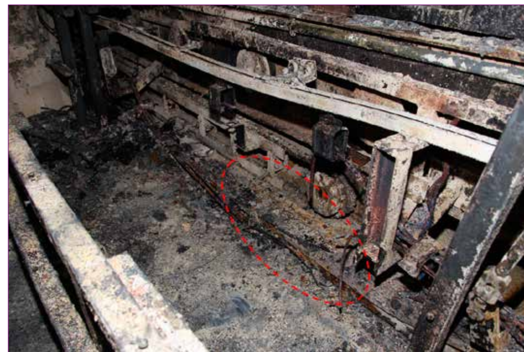
Obr. č. 4 – Detailní pohled do prostoru kriminalistického ohniska po odstranění ocelové konstrukce.
