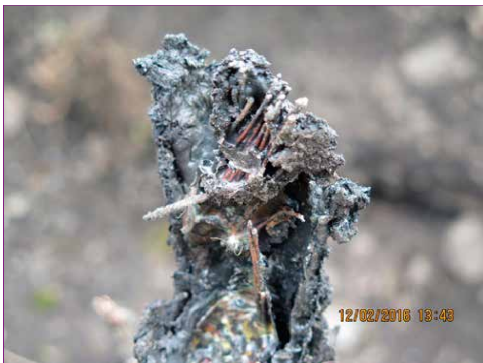
Obr. č. 3 – Poškození elektro kabeláže – nátava.
