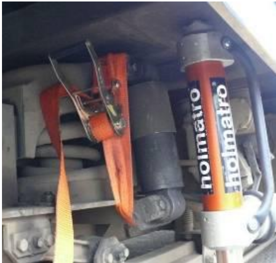
Obr .č. 37 Nouzové zajištění tlumiče
