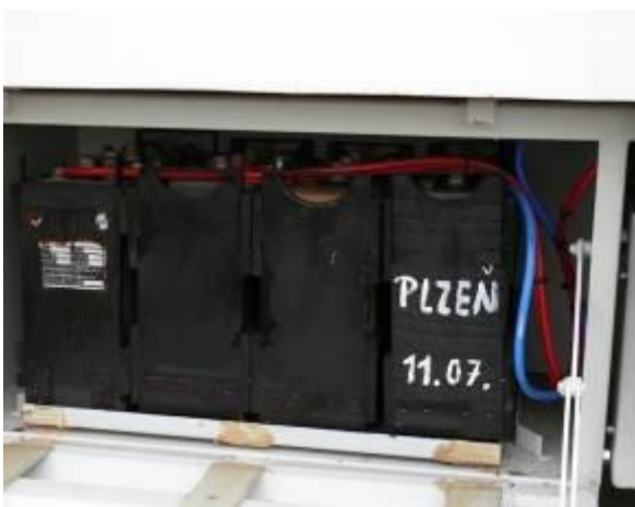
Obr. č. 14 Baterie
