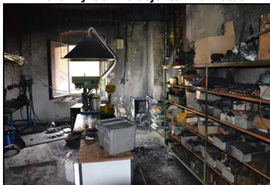
Požár výrobního objektu v Tanvaldu
